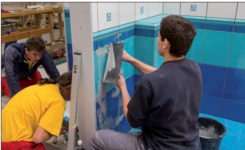
Soutěž „Obkladačská naděje“ pořádaný Cechem obkladačů České republiky, členem SPS v ČR, ukázala (již 10. ročník), že šikovní odborníci vyrůstají tam, kde se jim firmy dostatečně věnují. Foto: archiv Cechu obkladačů ČR
